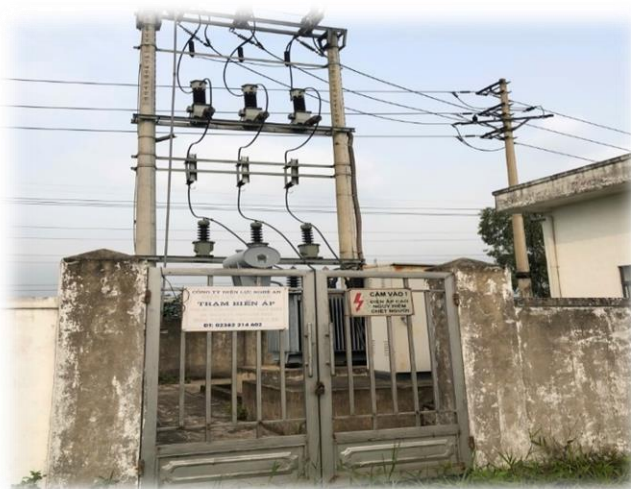
Hình 1. 5: Trạm biến áp của nhà máy
